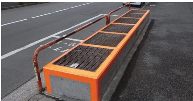
対策後の換気口
