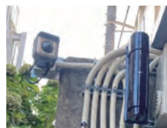
架道橋監視カメラ
