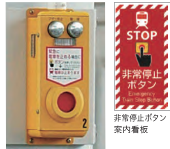
非常停止ボタン
