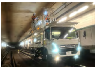
軌陸車を使用した架線設備点検
