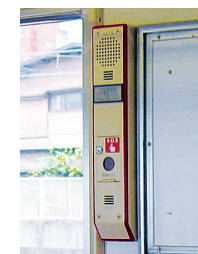
車内非常通報ボタン
