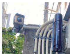
架道橋監視カメラ
