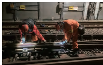
ポイント(転てつ機)の検査
