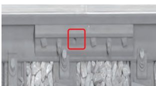
カメラ（静止画）によるボルトなどの抜けを検出
