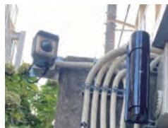
架道橋監視カメラ
