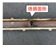
ショートしたレール絶縁部
