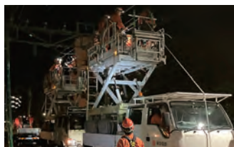
軌陸車を使用した架線設備点検
