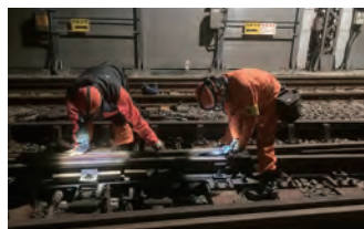
ポイント(転てつ機)の検査
