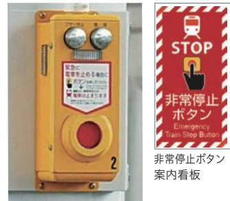
非常停止ボタン
