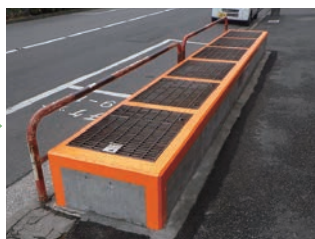
対策後の通風口
