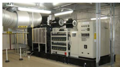
停電時に稼働する駅の非常用発電機
