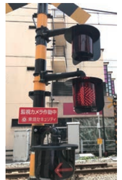
一部の踏切道に導入している全方位警報灯
