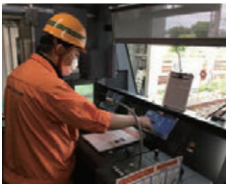
車両を制御する運転台の点検
