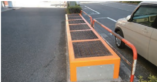
対策後の換気口
