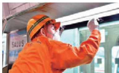
車両窓開け作業の様子
