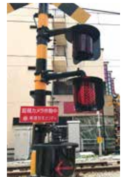
一部の踏切に導入している全方位警報灯
