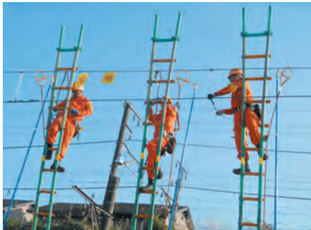
架線が溶損した際の復旧訓練。電気部の担当の技術員が速やかに復旧を行います。
