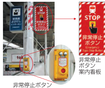
非常停止ボタン
