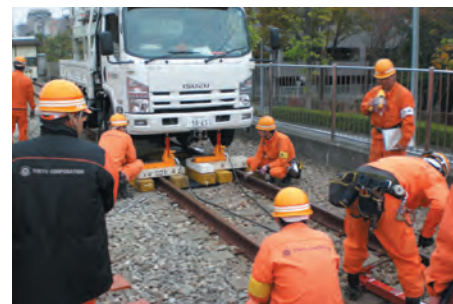
電気部門での技能講習会の一例：線路と道路の両方を走ることができる軌陸車の脱線復旧訓練を行い、異常時に対応できるスキルを身に付けます。
