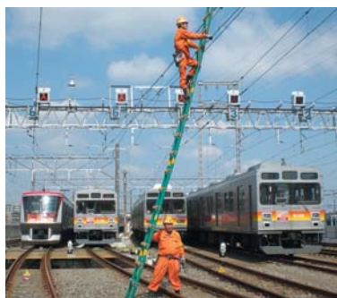
電気設備の保守
