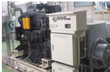
駅の非常用発電機
