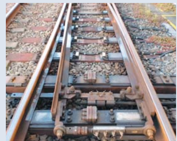
分岐器の電気融雪器 (枕木上にヒーターを設置し、雪を融かす)
