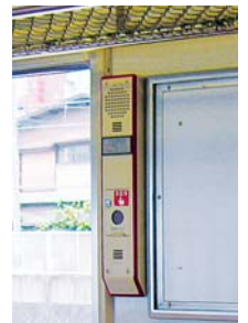
車内非常通報ボタン
