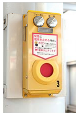
非常停止ボタン
