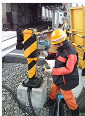
電気設備の保守
