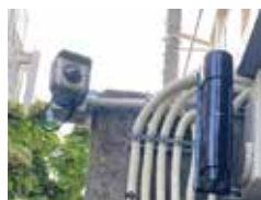
架道橋監視カメラ
