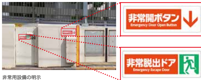
非常用設備の明示
