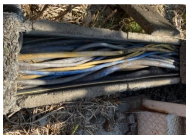
▲線路脇に敷設されている信号ケーブル
