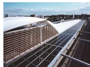
元住吉駅太陽光パネル
