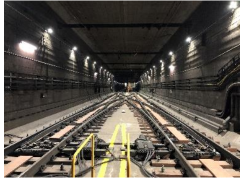
▲折り返し運転施設(用賀～二子玉川間)
