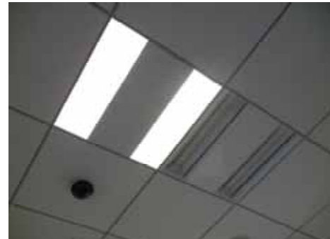
・奥の 700lx 5000K の照明拡大 (隣は既存の照明器具)
