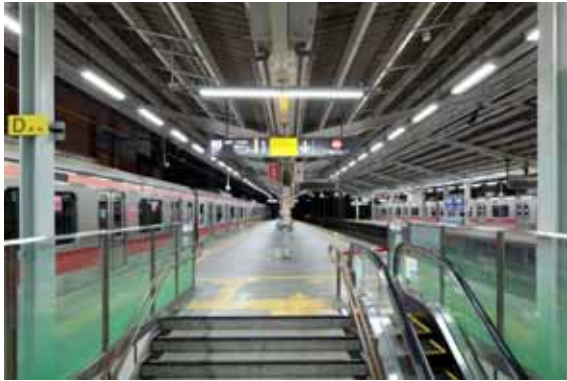
東横線ホームLED照明
