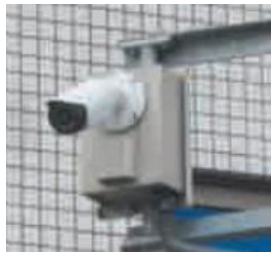
▲踏切監視カメラ
