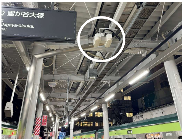
＜駅ホームに設置された5Gアンテナ＞
