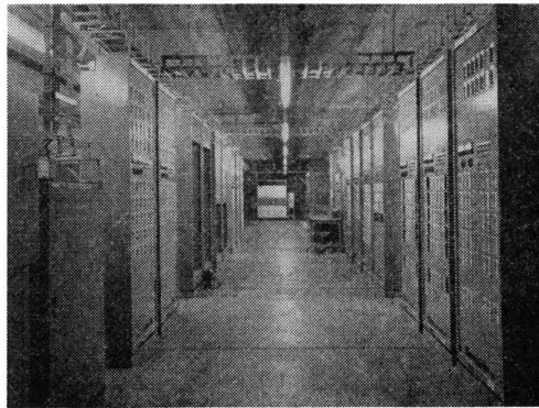
地下1階 信号機器室
