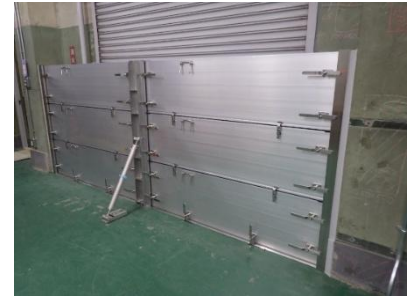
▲高津変電所 浸水対策(止水板設置済み)
