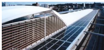
元住吉駅太陽光パネル
