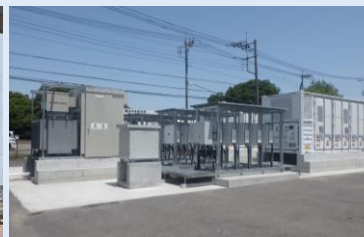
蓄電所事業の更なる拡大
