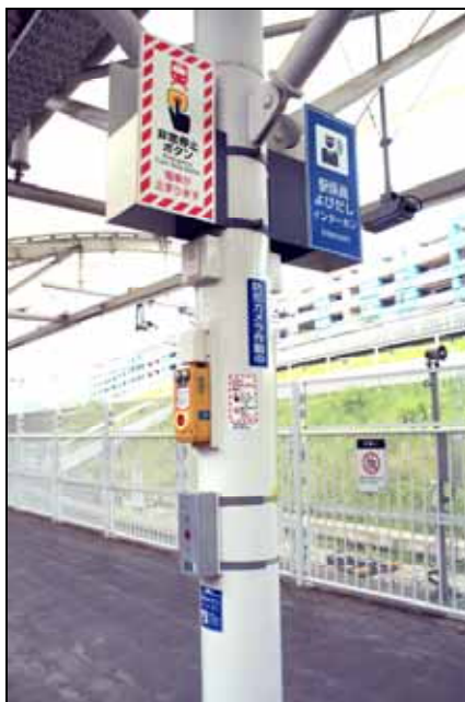
ホームの非常停止ボタン
